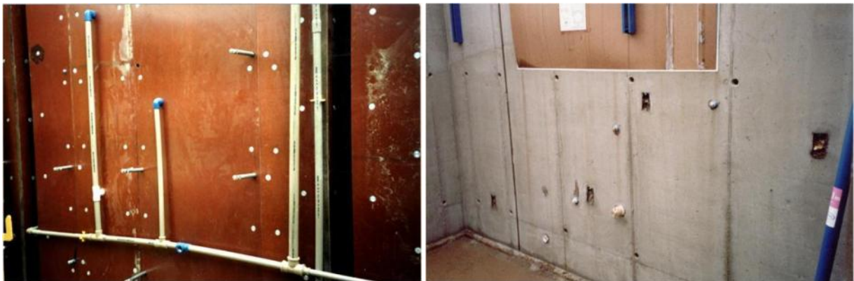
Figura 14 – Sistema de paredes maciças com embutimento de sistemas hidráulicos, sem a possibilidade de manutenção futura (fonte: arquivo Mercia Bottura de Barros).
