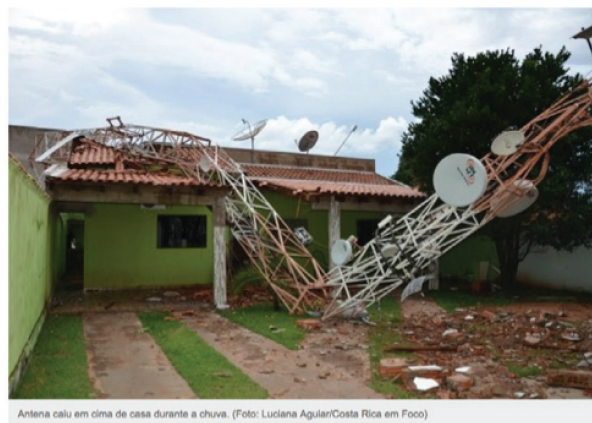
Antena caiu em cima de casa durante a chuva. (Foto: Luciana Aguiar/Costa Rica em Foco)
