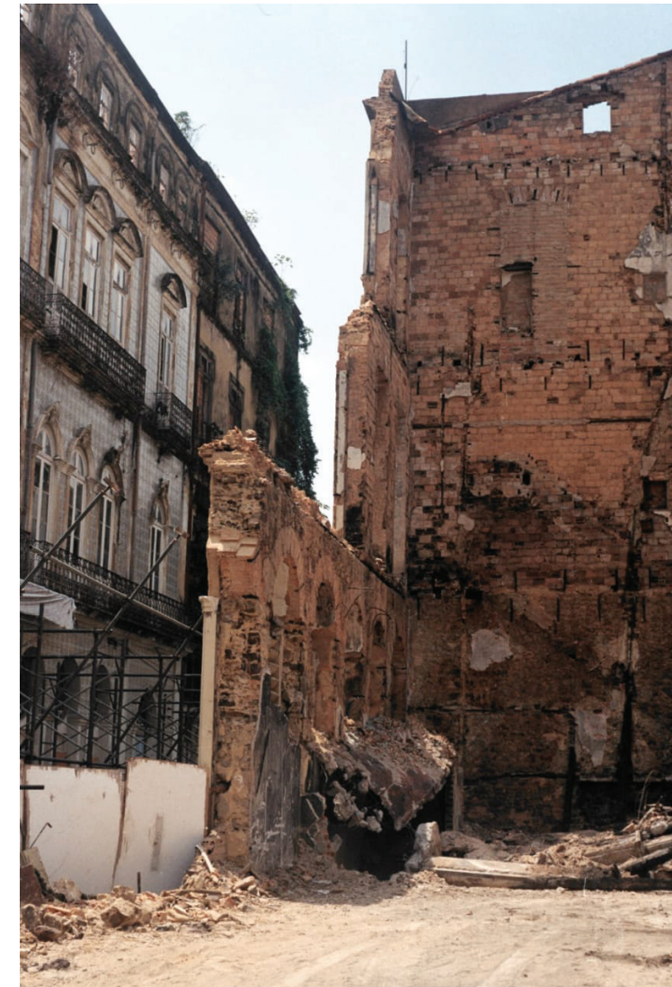
Figure 6: Lateral da farmácia César Santos, já em estado de ruína alguns meses após o incêndio, registrada em câmera analógica em outubro de 2015. Fonte: Leonice Oliveira, 2015
