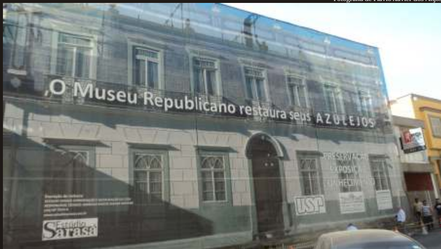
Tela de proteção decorada, durante as obras de restauração da azulejaria da fachada do Museu Republicano, em 2012. A azulejaria interna foi restaurada em 2011.
