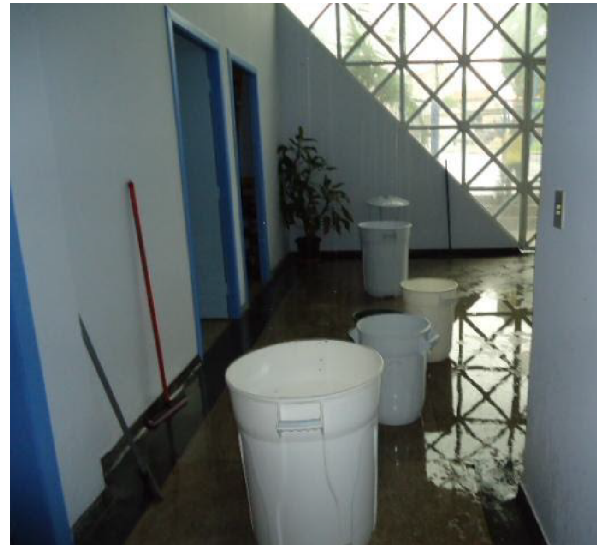
Cras Leste 2016 – comprometida por infiltrações
