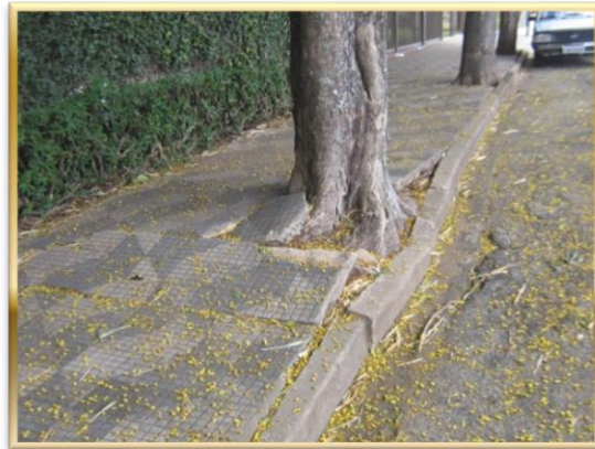
Imagem 22 – Afloramento de raízes em calçadas
