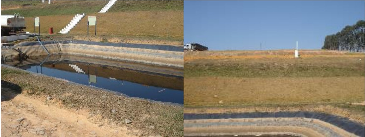
Figura 8 – Lagoa de chorume e tubo de drenagem vertical para gases, respectivamente, do aterro sanitário de Cachoeira Paulista.
