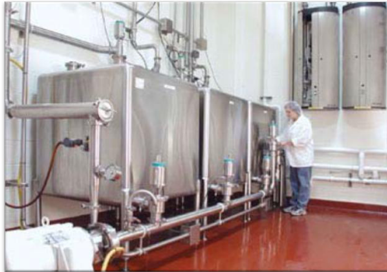
Figura 8 – Sistema CIP de limpeza.
