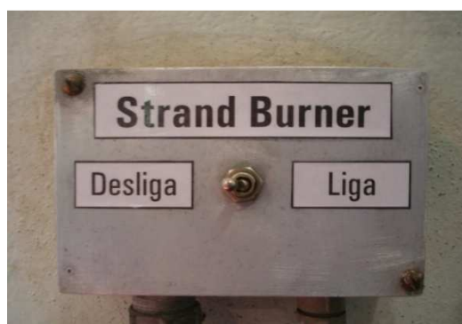
Figura 34 - Chave elétrica geral do Strand Burner .
