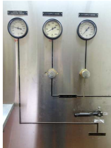
Figura 35 - Painel de Válvulas (Válvulas Surge Tank, LP Supply e HP Supply, respectivamente)
