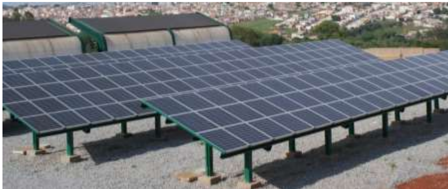
Figura 11. Mini Usina de Geração Fotovoltaica em parceria com CEMIG
