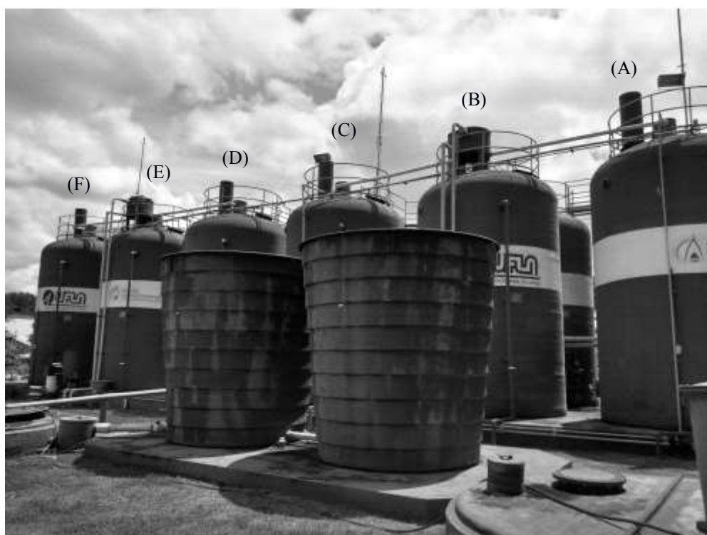
Figura 1 – Identificação dos seis reatores UASB instalados na ETE-UFLA.
